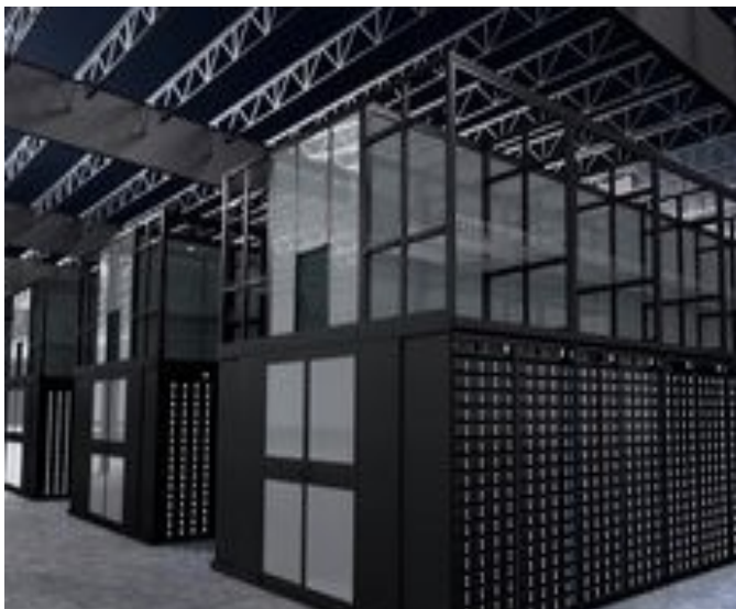
CyrusOne, plateforme de centre de données aux États-Unis, détenu par GIP, gestionnaire infrastructure
